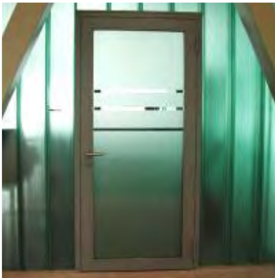
Brandschutz-Türen Schulhaus Leutschenbach in Zürich
